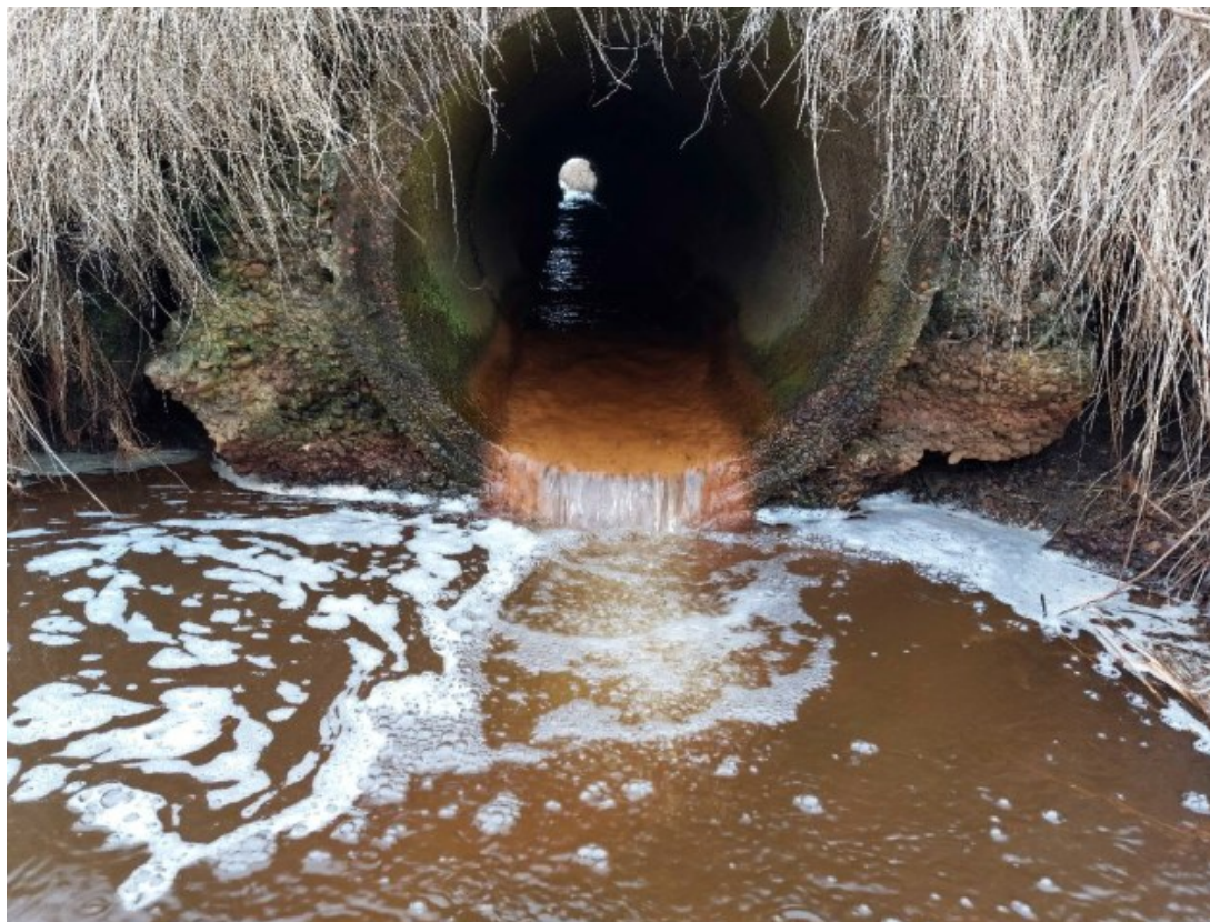
Ræhr Kærgroft rørunderføring under Rute 26
